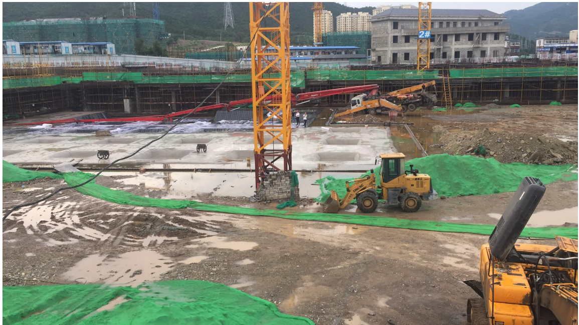
事故现场照片
